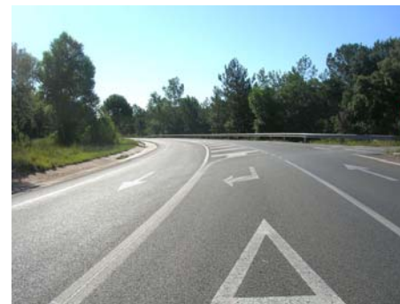
Des del carril d'incorporació, no obstant, la visibilitat és deficient.
